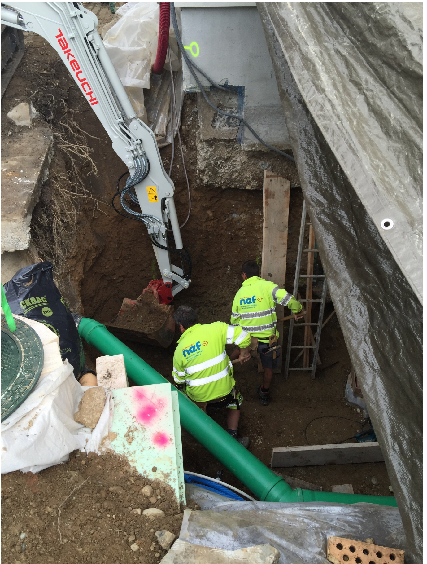
Regenwasserleitung grüne Rohre zum Regenwassertank zur Nutzung im Garten usw.
