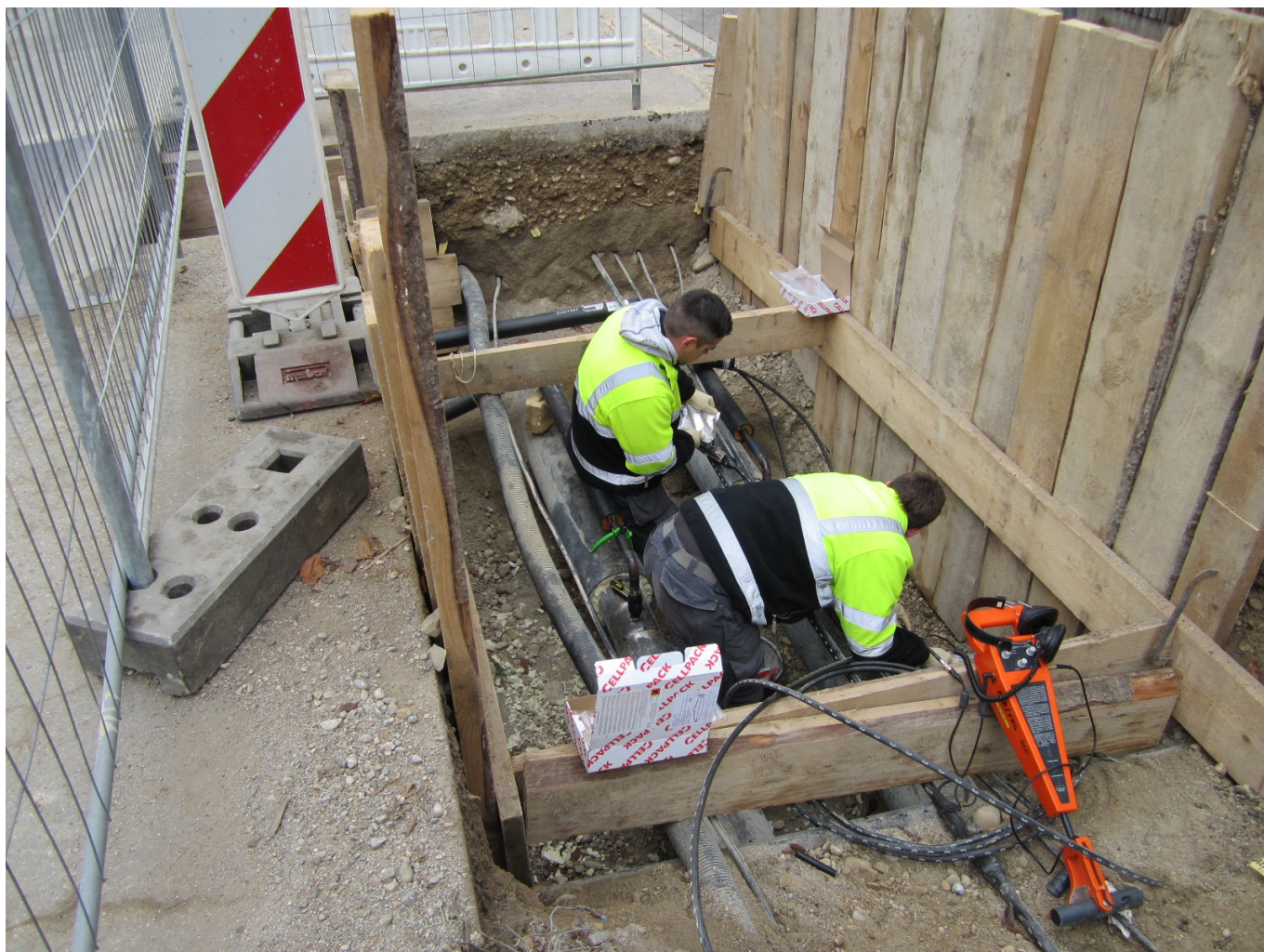
Grabensicherungen mit Holzdielen oder Metallelementen
