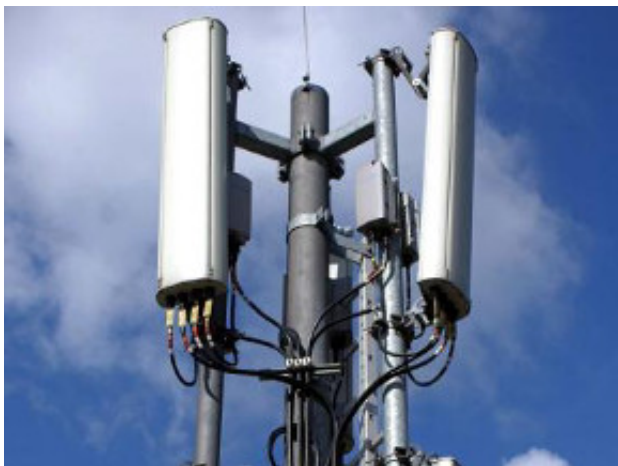
Mobilfunkmast mit den typischen drei Antennenteilen
